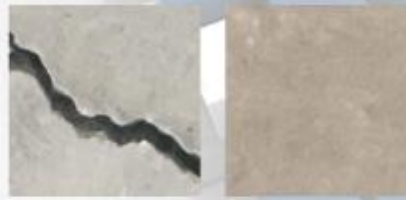
圖3.有裂痕與無裂痕的混凝土
